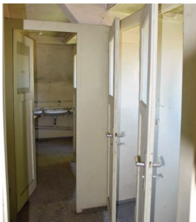
Vor allem im Inneren befinden sich die Räumlichkeiten in einem desolaten Zustand. Foto: pko/Archiv
